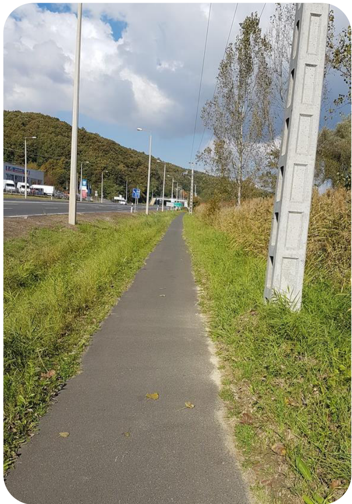
Salgótarján, MOL benzinkút – Ipari park közötti megrongálódott kerékpárút
