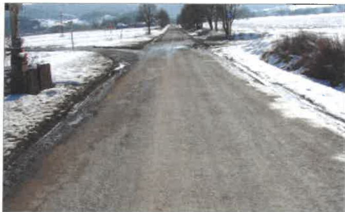
2124-es jelű Cserhátaláp–Szanda összekötő út 7+000–8+000 km szelvények közötti szakaszán végzett felújítás előtti állapota
