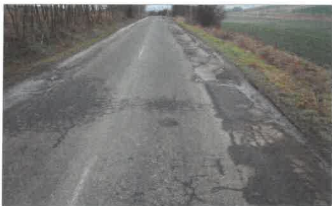
21148-as jelű Bujáki bekötő út 4+743–6+339 km szelvények közötti szakaszán végzett felújítás előtti állapota
