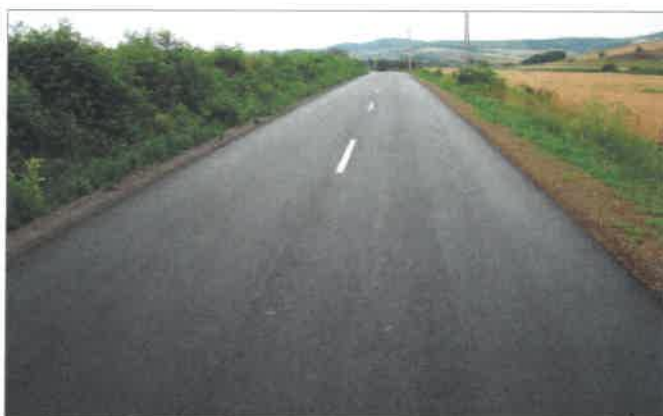
21148-as jelű Bujáki bekötő út 4+743–6+339 km szelvények közötti szakaszán végzett felújítás utáni állapota
